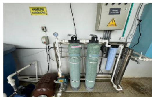
Ilustración PTAP - Planta De Tratamiento De Agua Potable 018400025
